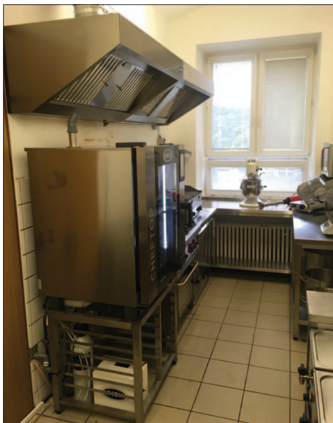
Vybavení stravovacího zařízení ZŠ a MŠ Polevsko
