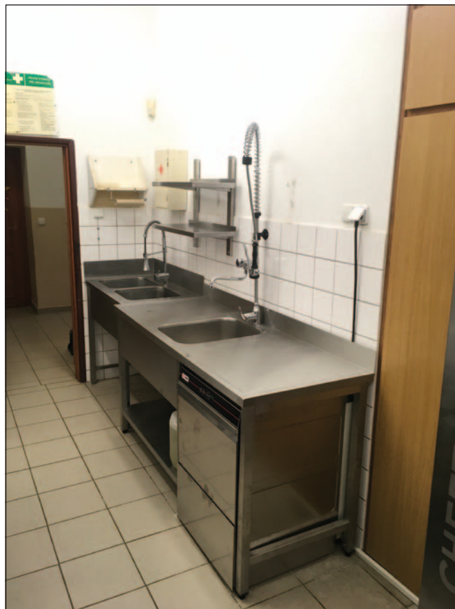
Vybavení stravovacího zařízení ZŠ a MŠ Polevsko
